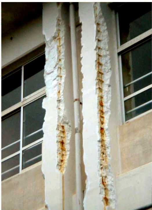
柱のコンクリートが一部剥がれ、鉄筋がむき出しとなった校舎＝7日、那覇市内
